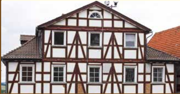
Unsanierete Fassade, verunstaltet durch die Fenster
