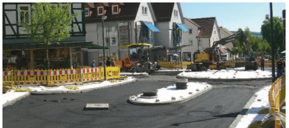
Auch die Einfahrt in die Altstadt wird durch den neuen Kreisel aufgewertet.
